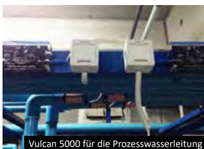
Vulcan 5000 für die Prozesswasserleitung
